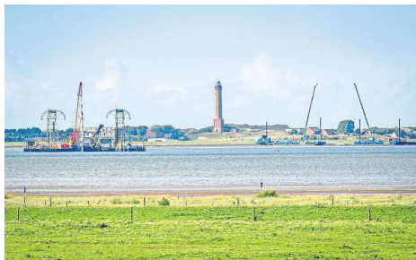
Investitionen am Meeresufer: Bauarbeiten für neue Stromkabel zwischen der ostfriesischen Insel Norderey und dem Festland.
