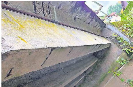
Die Bracht-Brücke bei Hesseldorf muss dringend saniert werden.
